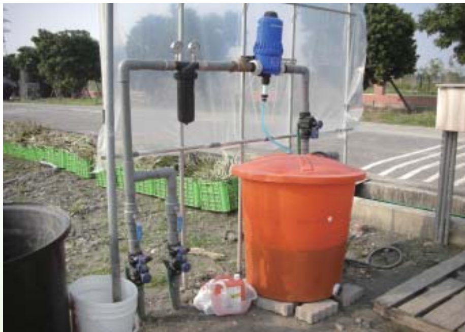
高雄區農業改良場使用的灌溉設施（藍色機體為定比稀釋器，黑色柱狀體含壓力表，為碟式過濾器）。
