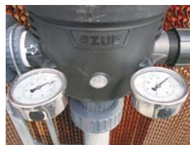
進出水口處壓力計
