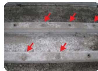
圖4. 堵塞的供水孔洞
