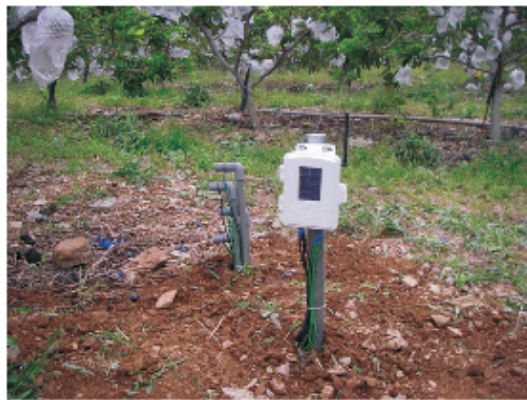
圖 7.感測器田間安裝情形
