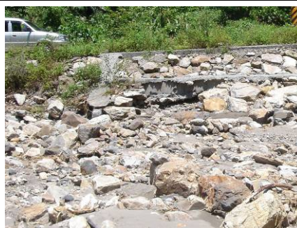
P11-眉原溪右岸護岸損壞
