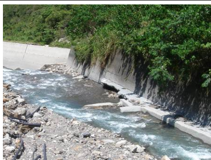
P10-西寶橋下游護岸基礎淘刷
