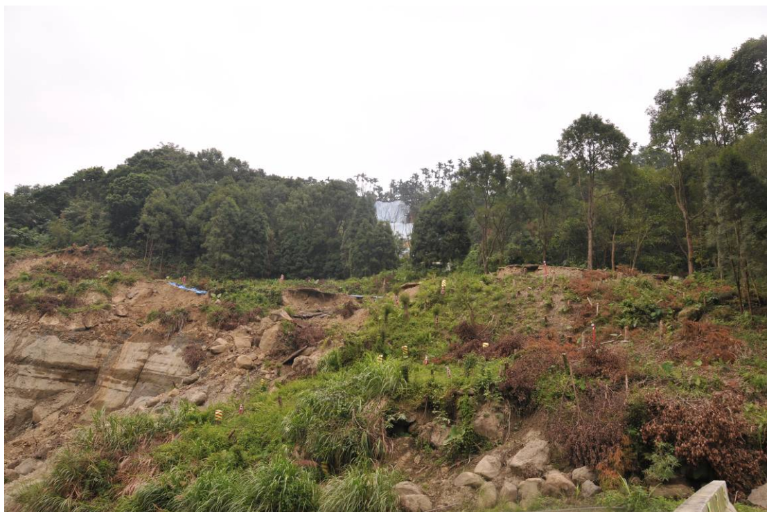
圖 5-6 現地崩場地情形(2009/11/03)
