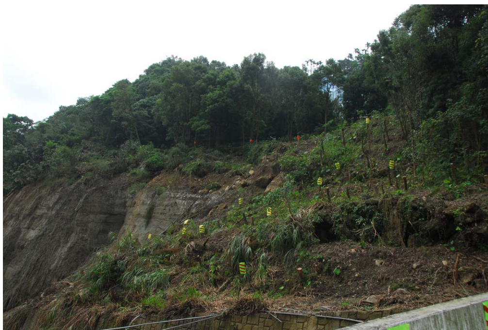
圖 3-1 河道上邊坡崩落照片(2009/10/02)
