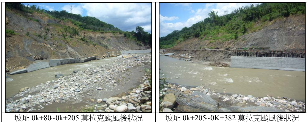
圖2-8-2 莫拉克颱風後破損情形
