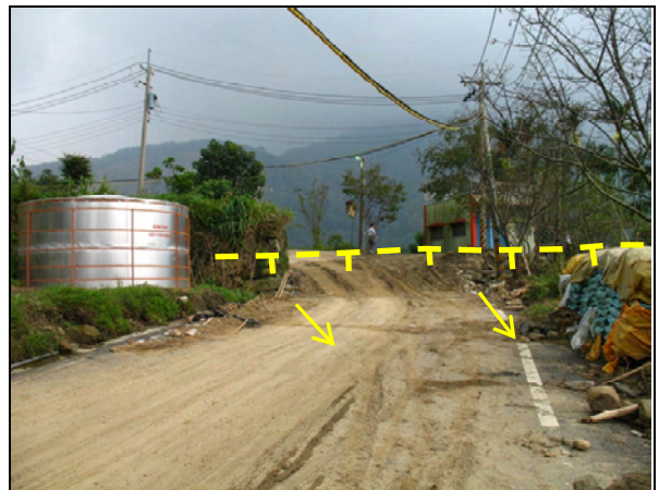
(6)東側崩崖通過縣道 166 道路下陷(98/8/24)
