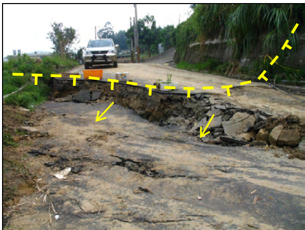
(5)西側崩崖通過縣道 166 道路下陷(98/8/24)
