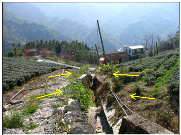
(4)排水設施滑動擠壓破壞(98/8/24)
