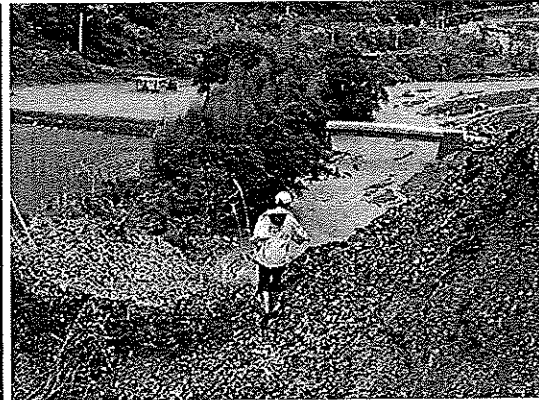
道路上邊坡崩塌情形
