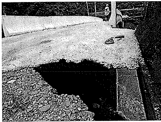
橋樑基礎淘空情形
