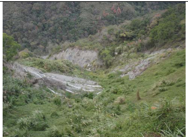
照片六 崩塌範圍下邊坡為堆積區，且有相當顯著的沖蝕溝出現，下方之合望溪床為充滿大多為板岩碎屑堆積為主。
