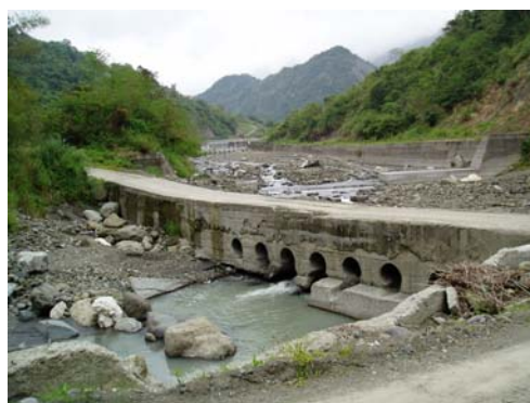
《過水路面基礎掏空》 樂合溪： (X=284672 Y= 2579762)
