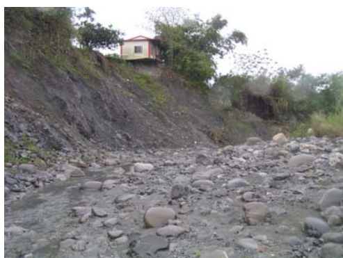
《左岸有崩塌，工寮隨時有崩落之危險》 富源溪：安夜西溪上游 (X=290855 Y= 2601952)
