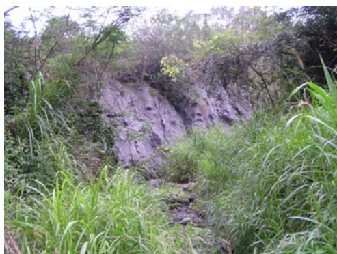
《右側河岸無護岸，坡腳沖刷邊坡崩塌》 螺仔溪上游： (X=278301 Y= 2565906)
