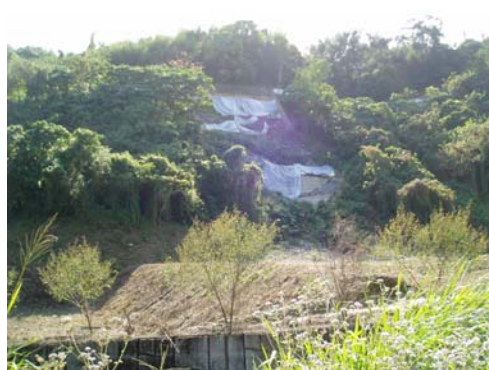
《通往崙山產道下邊坡崩塌》 秀姑巒溪中游：三民 (X=284145 Y= 2595563)
