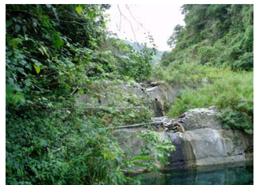
《跌水工略為破損》秀姑巒溪上游： 崙天溪上游 (X=273343 Y= 2568748)
