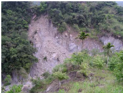
《右側河岸無護岸，坡腳冲刷邊坡嚴重崩塌》 安通溪上游： (X=285231 Y= 2575760)
