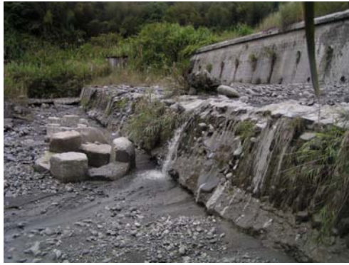
《下游略有冲刷，基礎裸露》 富源溪：和諧橋上游 (X=291508 Y= 2608853)
