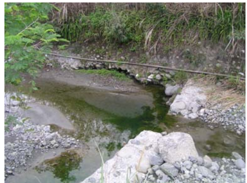
《固床工下方、護岸基礎掏空損毀》 富源溪：興鶴橋上游 (X=290241 Y= 2603790)
