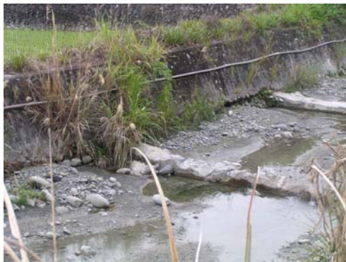
《固床工下方、護岸基礎掏空損毀》 富源溪：鶴岡橋上游 (X=290192 Y= 2603718)
