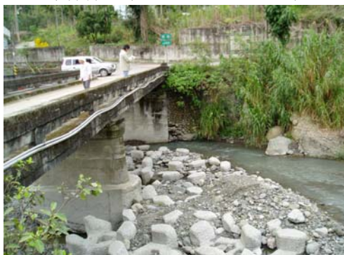
《橋樑護岸基礎部份略有掏空》 阿眉溪：安夜西溪上游 (X=291193 Y= 2602457)
