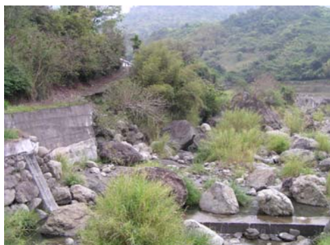
《右岸處護岸斷裂流失》 鯢溪上游： 吉哈拉愛橋上游 (X=277973 Y= 2560538)
