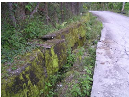
《地滑地護坡斷裂，路面龜裂破損》 安通溪上游： (X=285125 Y= 2575684)
