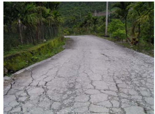
《同上張，地滑地無護岸致使路面龜裂破損》 安通溪上游： (X=285231 Y= 2575760)
