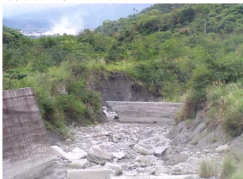
《固床工斷裂、護岸倒塌損毀》 富源溪：安夜西溪上游 (X=291193 Y= 2602457)
