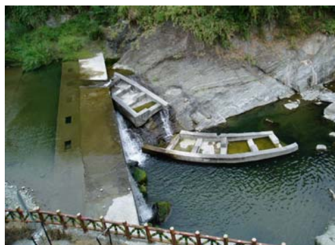
《下游面刷深致使魚道斷裂》 鯢溪上游： (X=277093 Y= 2560330)
