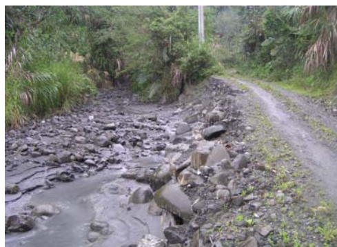
《左岸護岸流失，長約 60 公尺》 富源溪：安夜西溪上游 (X=292697 Y= 2605207)
