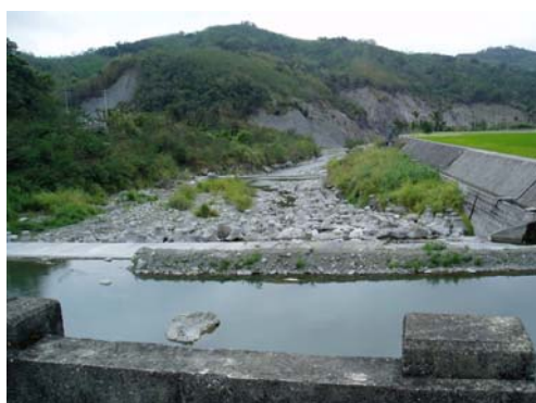
《左岸坡腳沖蝕崩塌》 鯢溪上游： (X=276444 Y= 2560347)
