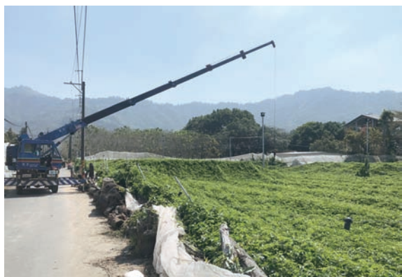
圖8. 地錨強度不足導致二層棚垮棚
