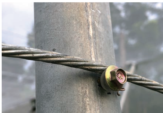
圖9. 利用攻牙釘頂住鋼索，棚架過重易導致攻牙釘斷裂。
