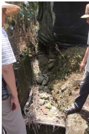
雨水的沖刷導致排水溝毀損
