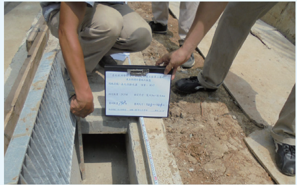
▲ 水土保持計畫施工中檢查－臺北歐洲學校陽明山校區新建工程第三基地
