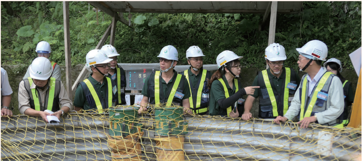
▲梅花地滑區整治工程 - 集水井開口採防護措施，防止墜落危害（新竹縣尖石鄉）
