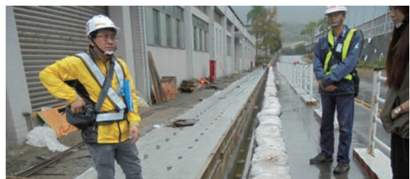
▲ 水土保持計畫施工中檢查 - 光華營區污水下水道新建工程
