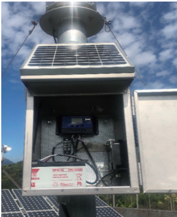
▲ 低功耗廣域網路技術結合雨量站現況
