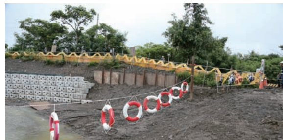
▲ 出火橋下游野溪整治工程（屏東縣恆春鎮）—鄰水作業職業安全衛生設備設置，以預防災害發生
