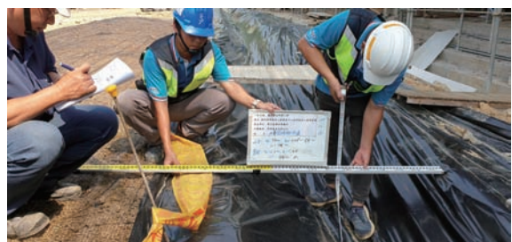
▲ 水土保持計畫施工中檢查 - 繼光營區新建工程 (臨時排水溝)
