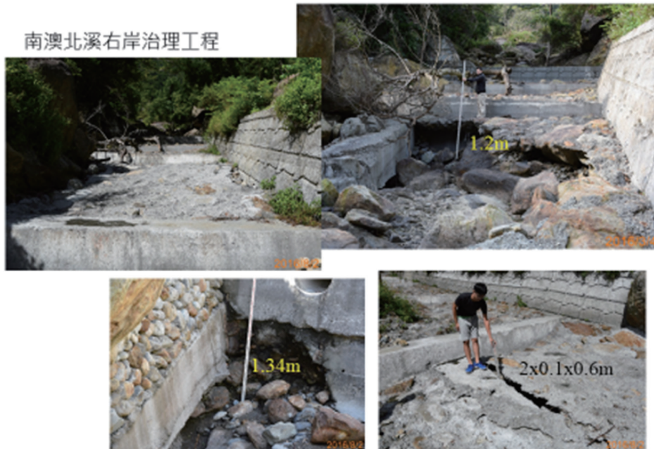
照片 4 水墊工程厚度破壞 Pic.4 Destruction of water cushion
