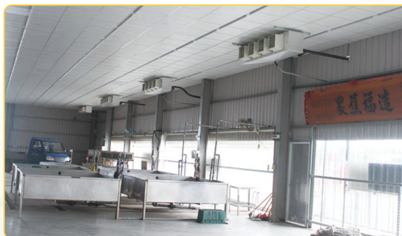
● 圖 22. 包裝場冷房設備
