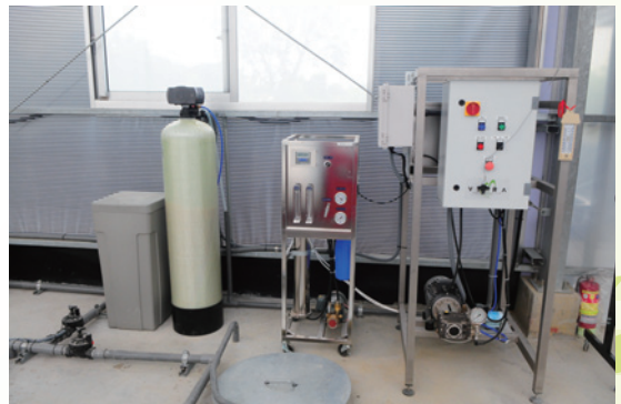
圖6.5 噴霧系統主機及RO水設備
