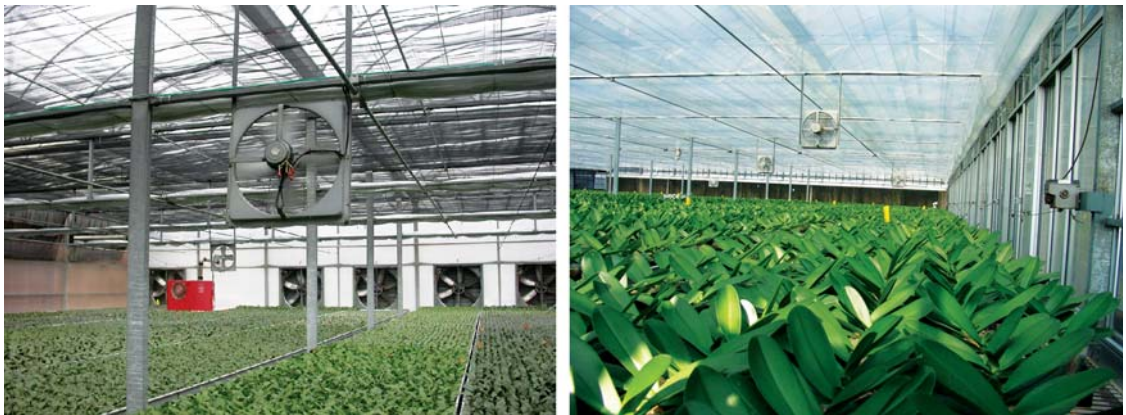
圖13.水牆風扇降溫系統的負壓風扇(左)和內循環風扇(左、右)，水牆(右)、內遮光網(左)、和上方隔熱膜(右)。左圖紅色方形為柴油加溫機。
