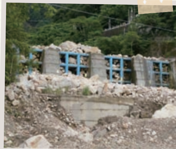
利用河道中的工程構造物，可以阻擋大部分的土石往下游移動。
