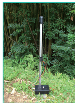
說明：Wifi無線通訊及紅外線光牆感測器設置情形
