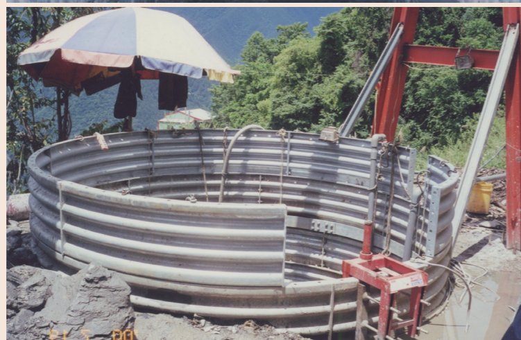
臺中和平梨山-地滑整治工程排水廊道及集水井。
