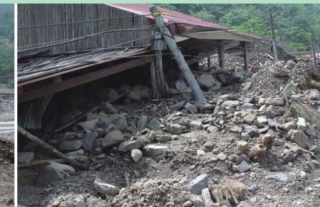
●瑪雅里受土石流掩埋之民舍 （2009年8月）
