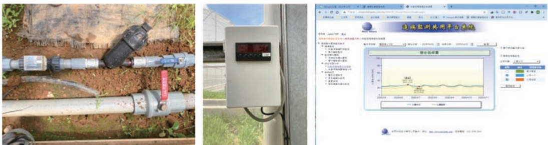
圖 1-12~14、土壤供水流量計監測與控制設施建構
