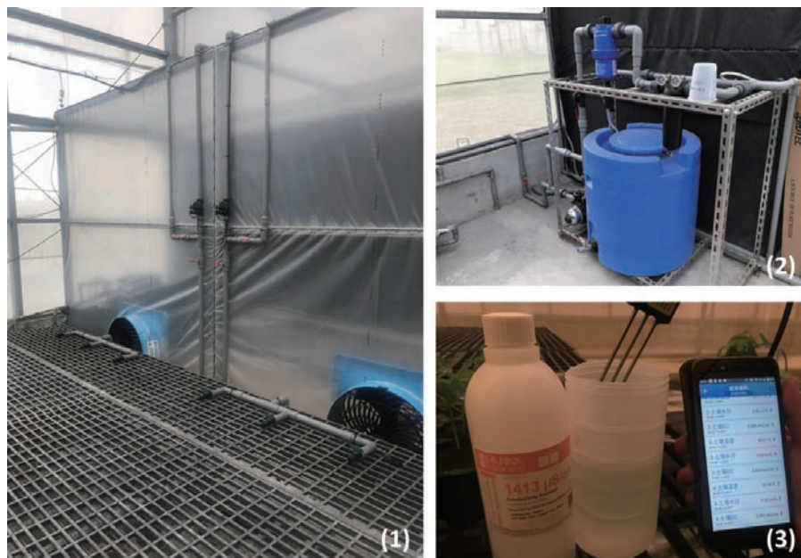
圖 4-9、屏東種苗研究中心高效隔離溫室環境改善情形。(1) 噴灌與滴灌系統建置；(2) 養液系統建置；(3) 土壤環境監控系統
