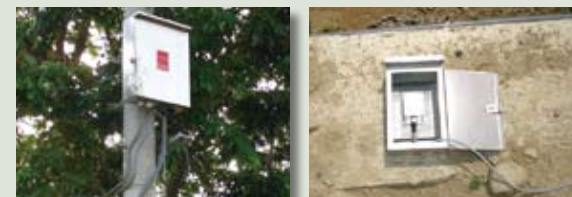
邊坡監測儀器——傾度盤、遙控攝影機
