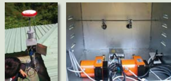
邊坡監測儀器——單頻道衛星定位、伸縮計
