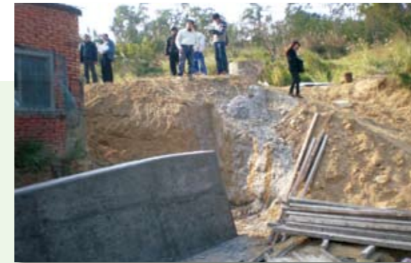
違規開挖整地闢建擋土牆
