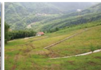
和雅村石壁頭崩塌災害復建工程
