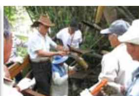
新竹縣北埔鄉南埔社區利用雇工購料百年水車有老師傅技術傳承來修復
