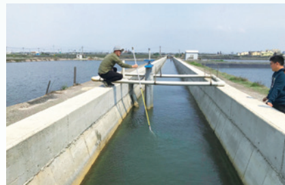
雲林縣新港北養殖漁業生產區－檢視養殖生產區排水路淤積情形
