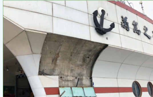
澎湖區漁會第二漁港漁產品直銷中心牆面破損
