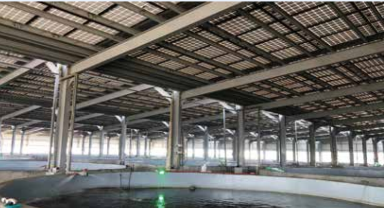
室內水產養殖設施結合屋頂型太陽能綠能案場
