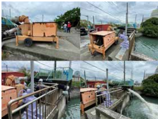
臺南市北門區蘆竹溝1號水門旁移動式抽水機維運管理情形抽查
