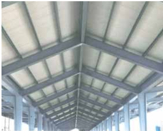
正濱卸魚場天溝及樑柱銹蝕漏水改善
