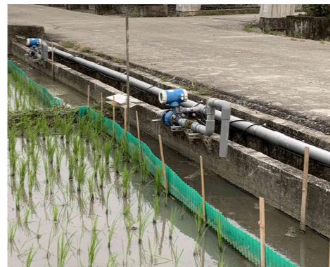
▲ 智慧水閘可透過遠端控制閘門開啟，執行間歇灌溉作業
