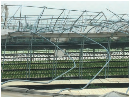
圖 11. 設施損壞容易被害物侵入，造成危害
