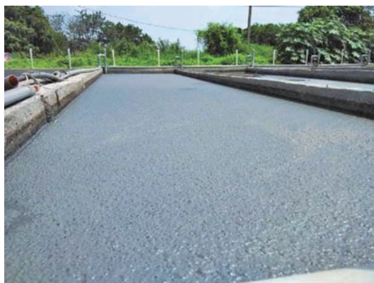
廢水處理設施中之兼氣池厭氣槽
