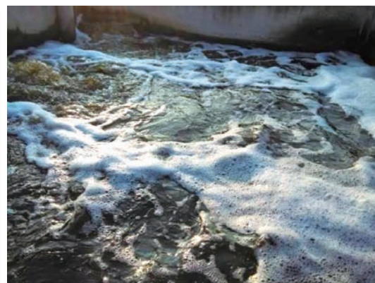
廢水處理設施中之曝氣池
