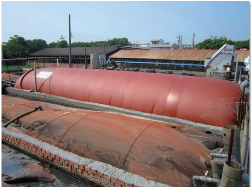
廢水設施設置紅泥膠皮袋，以提升廢水處理效率
