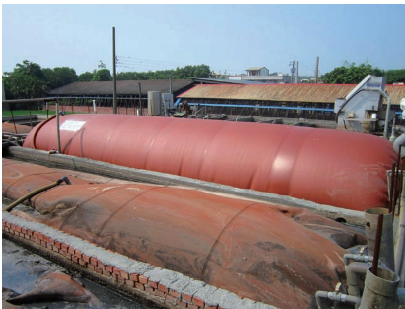
廢水設施設置紅泥膠皮袋，以提升廢水處理效率
