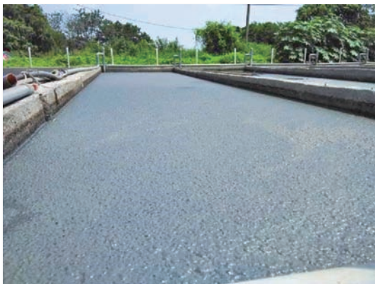
廢水處理設施中之兼氣池厭氣槽
