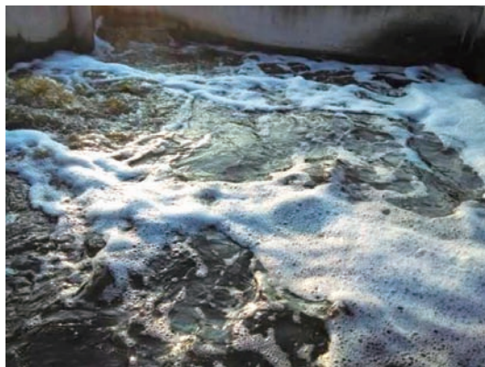
廢水處理設施中之曝氣池
