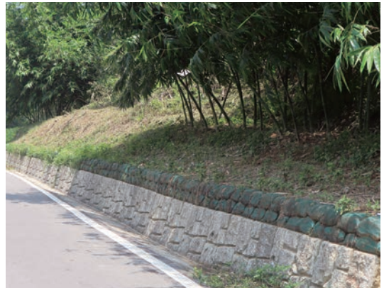
新竹縣寶山鄉字紙亭農路改善工程將剩餘土方以土袋包裝、堆疊於邊溝頂端，減少混凝土用量
