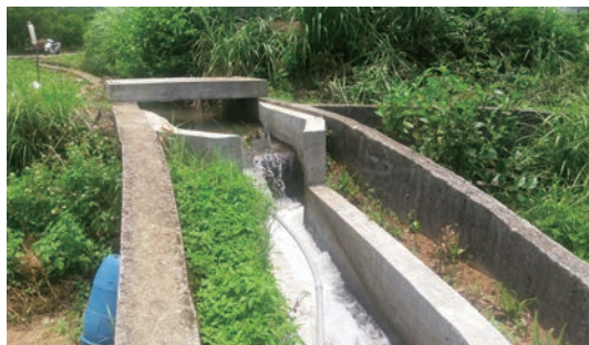
早期為穩固溝渠水圳改建為水泥渠道衝擊生態環境與視覺景觀
