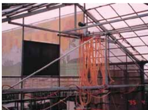
連棟設施內單軌懸吊噴霧系統
