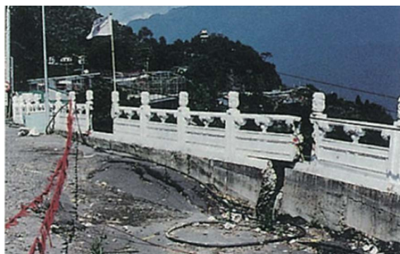
道路下陷，路基流失 照片來源：《滴水培土—守護大地—世情》，民國 102 年
