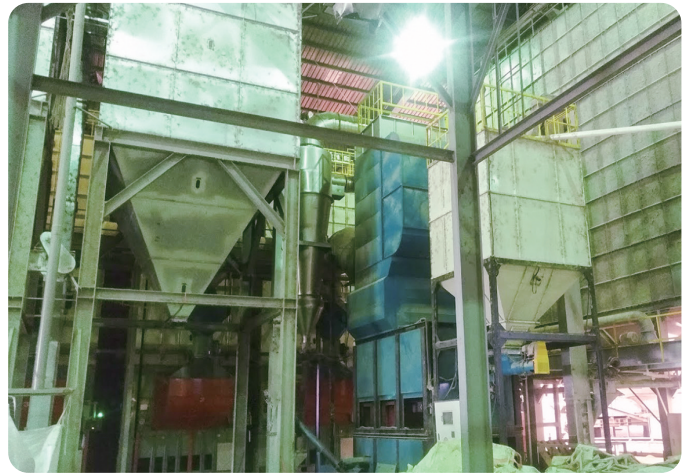
圖4. 燃糠爐可將燃燒稻殼的熱源回收烘濕穀及炭化稻殼為碾米廠處理農業生產剩餘資材利器
