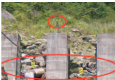
上游雨量計及鋼索檢知器
