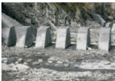
松鶴一溪下游鋼索檢知器
