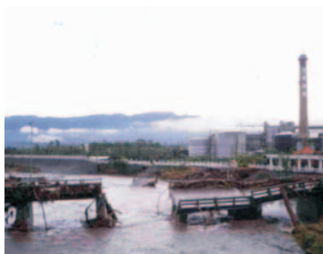
橋受土石衝擊破壞
