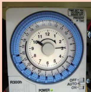
機械式定時器，左下方盒蓋打開可看見停電保持電池
