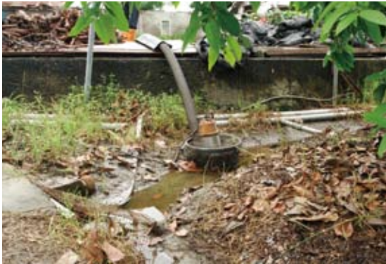
▼圖11、雨季時可利用抽水機加速排水
