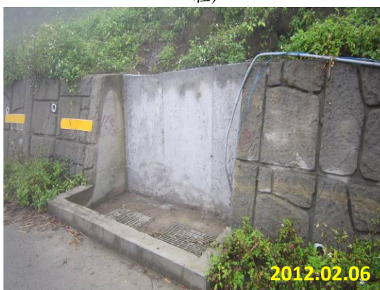
照片 5-20 集水井 (農苗義 017-昆陽農路改善工程)
