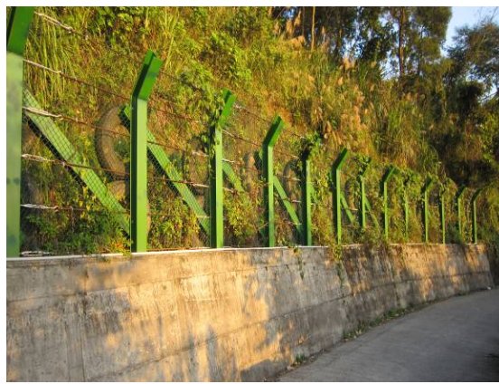
照片 5-22 防墜落石網 (農中新 008-水底寮農中新 008 農路改善工程)
