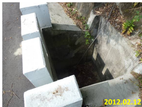
照片 5-42 集水井 (農南龍關 007-崎頂農路改善二期工程)
