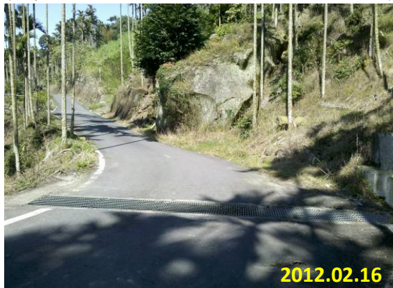
照片 5-31 橫向排水
