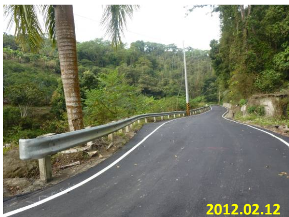
照片 5-36 鋼板護欄 (農嘉大 042 -四維橋旁農路改善工程)
