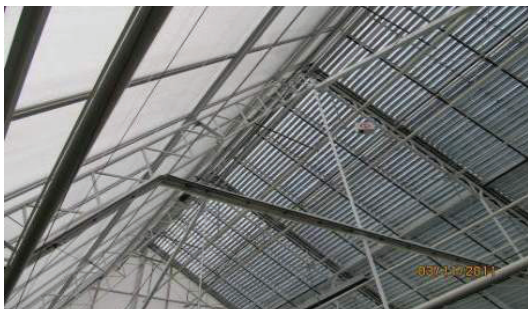
圖 13.溫室屋頂百葉板太陽能加熱管路
