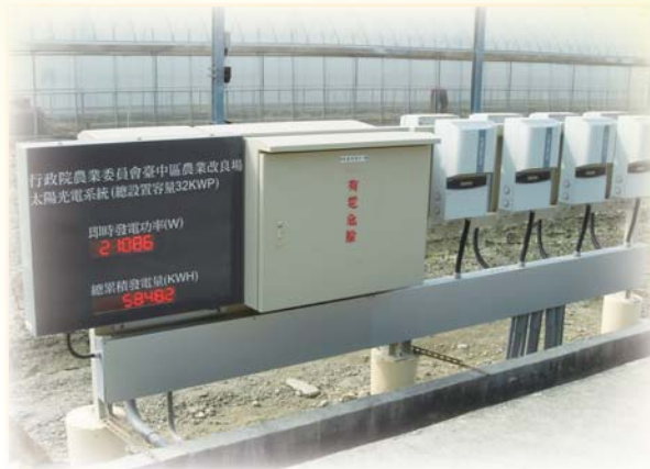
▲戶外型LED展示板及直交流轉換器等電控設備
