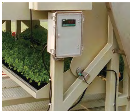
▲懸吊承盤之定位控制與數位電表
