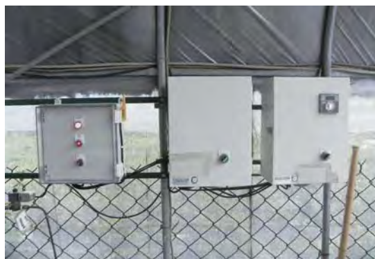
▲無線環控驅動主機 (左邊依序為無線環控驅動主機、內循環風扇控制箱、細霧降溫設備控制箱)
