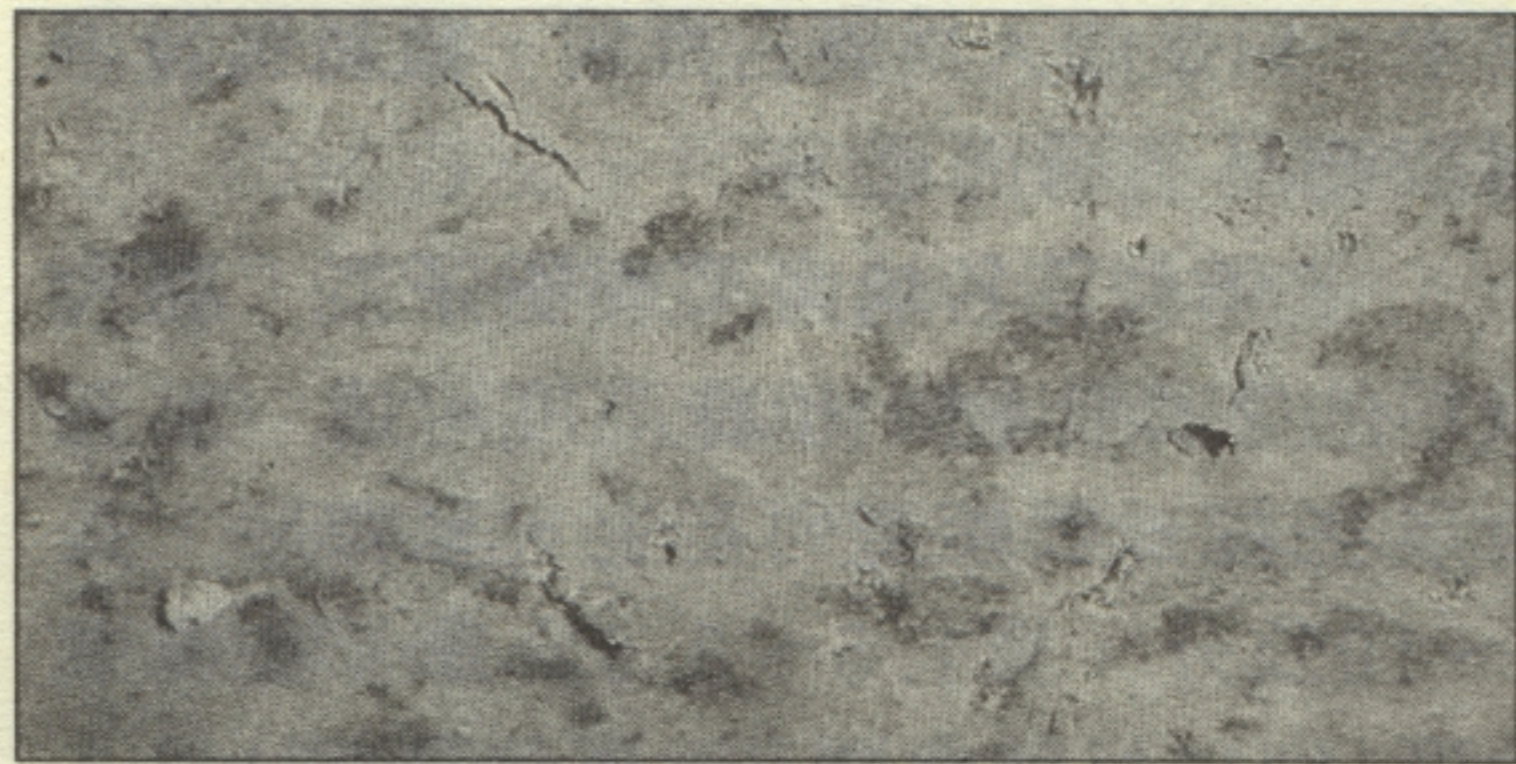
排水不良所產生之灰銹斑
