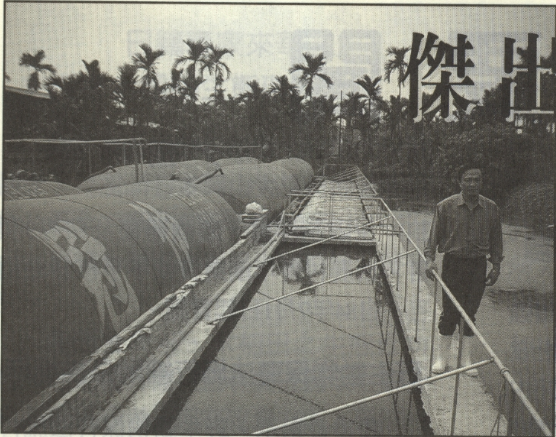
三段式的廢水處理設施
