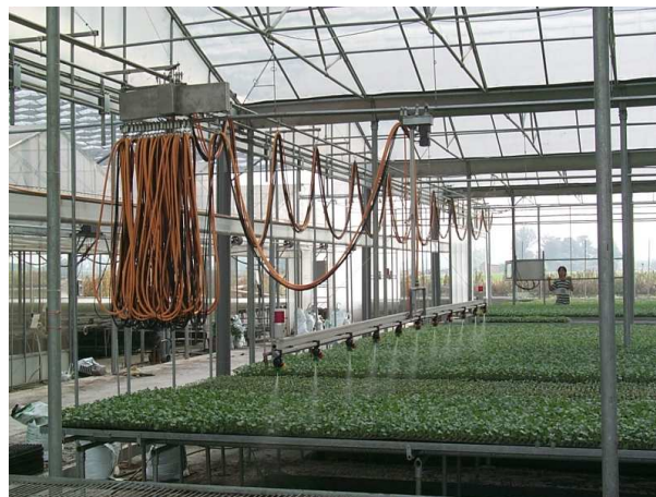
圖十八、裝設於二林連發育苗場之五連棟溫室用自動換棟型懸吊桿式噴霧系統
