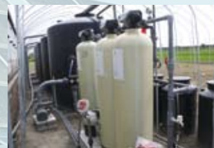
▲試驗區之雨水儲存桶與過濾裝置
