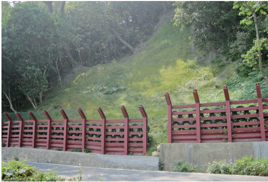
道路上邊坡崩塌，植生復育、施作攔石柵，保護行人及車輛通行安全。（攝影／邵龍雨）
