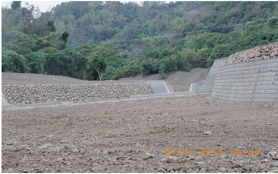
疏通河道土砂淤積，設置固床工導流，防止縱向沖蝕。（攝影／王偉州）
