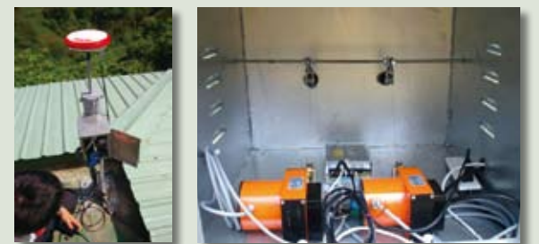
邊坡監測儀器——單頻道衛星定位、伸縮計
